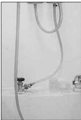
Figura 2 - Sistema di deionizzazione dell'acqua presso R&R
